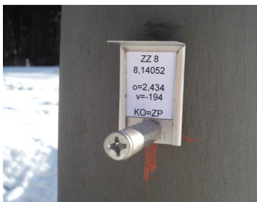
Obr. 2.3.1.10 – Konzolová zajišťovací značka stabilizovaná na podpěře TV
