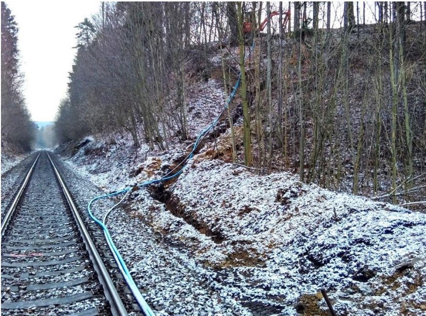
Obr. 2.3.6.6 – Vedení kabelové trasy
