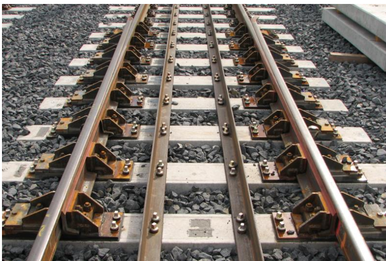
Obr. 4.6.1.12 Kolejnicové velmi velké dilatační zařízení
