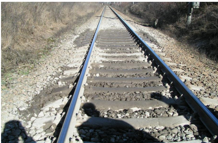
Obr. 3.8.1 - Příklad nefunkčního odvodnění koleje a vznik blátivých míst se znečištěním kolejového lože
