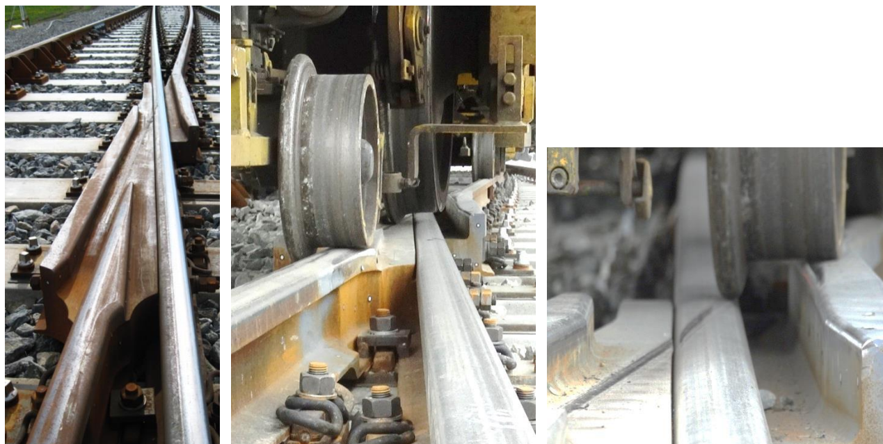
Obr. 4.6.2.5.4 Srdcovka s průběžnou kolejnicí v hlavním dopravním směru; průjezd podbječky v odvrtném směru
