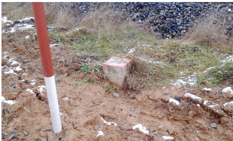
Obr. 2.3.6.4 – Bod ŽBP, u kterého bylo porušeno ochranné pásmo a jeho poloha byla ovlivněna stavební činností
